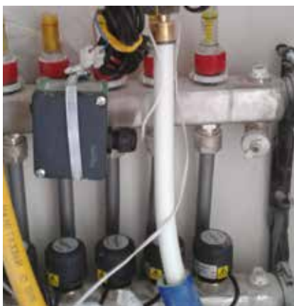
Рис. 6. Коллектор с НЗ клапанами, термоприводами MZ140-230B и накладным датчиком температуры смесительного узла STC100
