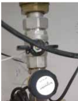
Рис. 10. Клапан VZ208E с приводом MZ140-230D в линии подачи горячей воды в полотенцесушитель
